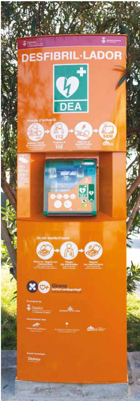
Instal·lació del desfibril·lador fix de dues cares a la plaça Catalunya.
