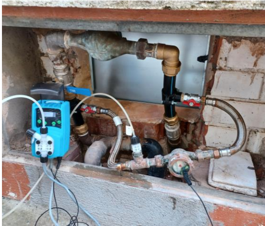
INYECCIÓN CONTROLADA DE CLORO
